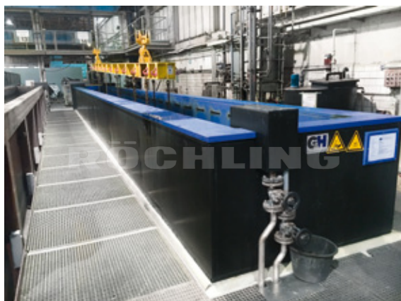
Beisanlage für nahtlose Rohre bei der Mannesmann Stainless Tubes Deutschland GmbH in Remscheid/Deutschland: Zum Einsatz kommt ein Beizmedium mit bis zu 18 % Salpetersäure und 7 % Flußsäure
