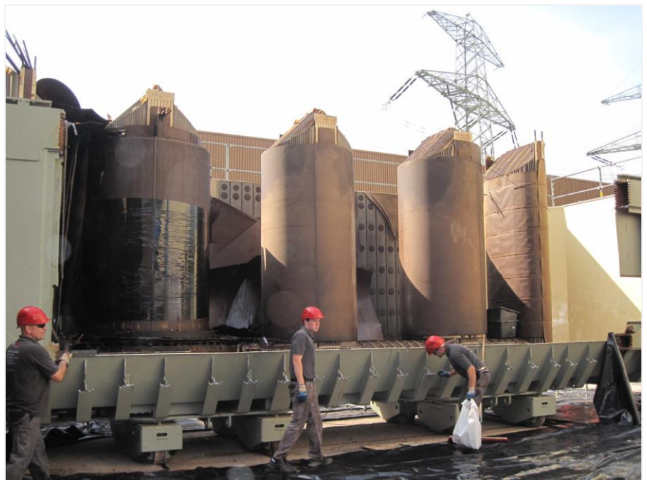
Demontage des 750 MVA Trafos: Der Trafo war seit 1981 im AKW Grohnde in Betrieb; hieraus stammen die Lignostone®-Bauteile für die Untersuchung
