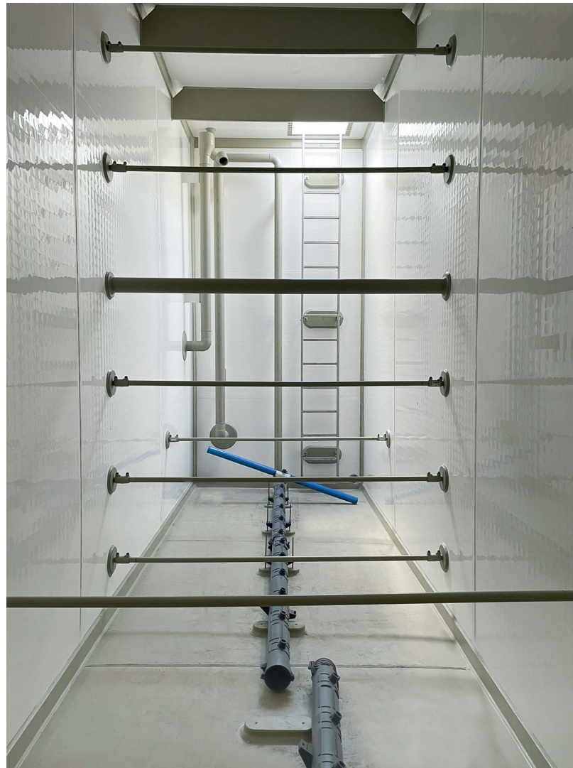
Hohes Fassungsvermögen: Im neuen Pufferspeicher wird Abwasser aus der Produktion sicher zwischengespeichert
