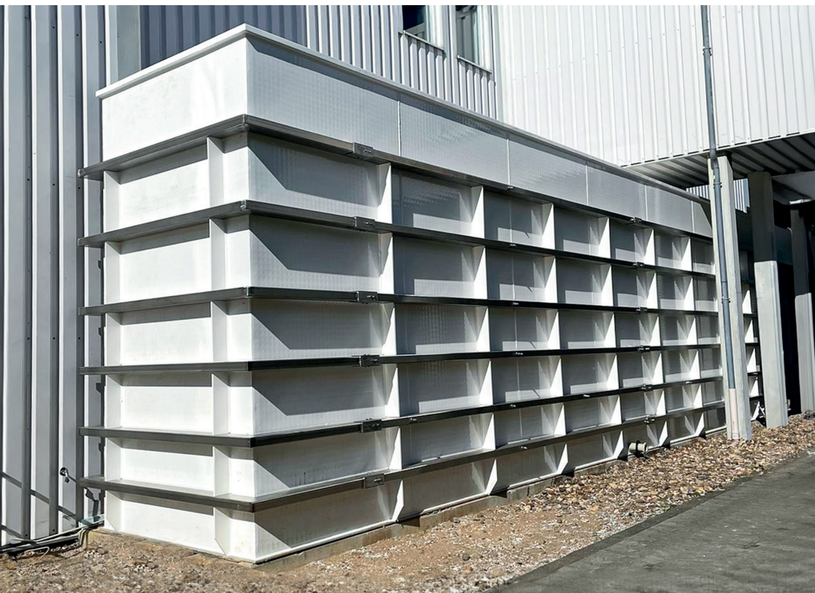
Abwasserspeichersystem: Gehört mit seinen 100 Kubikmetern Fassungsvermögen zu den sehr großen Behältern dieser Bauweise
