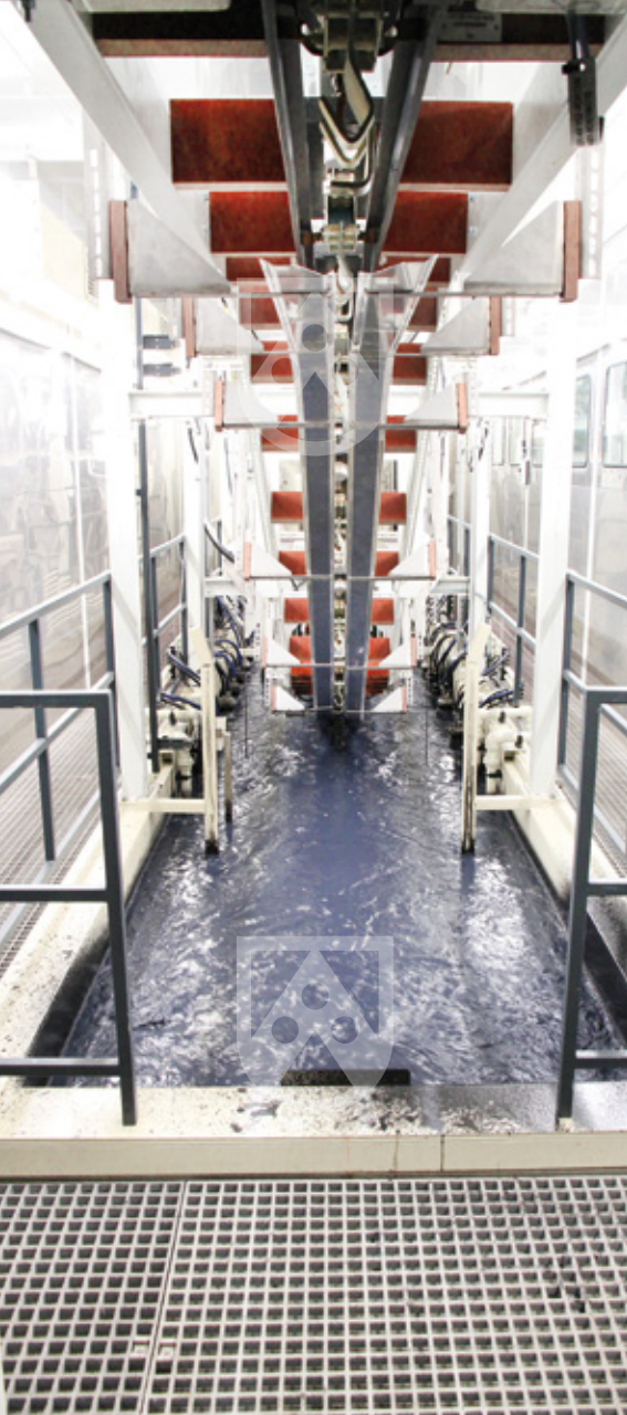
In Betrieb: Voll ausgestattetes Becken nach der Installation in der BMW Motorrad Produktionshalle
