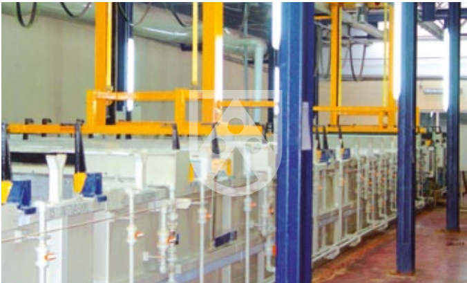
Galvanisierungsanlage Electroplating plants
