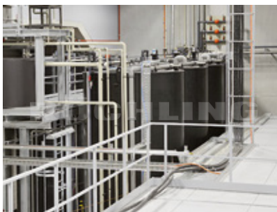
Behälter in einer Abwasseranlage aus Polystone® G schwarz B 100 Tanks in a waste water plant made of Polystone® G black B 100
