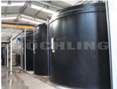
Behälter für die industrielle Wasseraufbereitung Tanks for industrial water treatment
