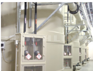
Behälter einer Wasseraufbereitungsanlage aus Polystone® P Homopolymer grau Tanks for a water treatment plant made of Polystone® P homopolymer grey
