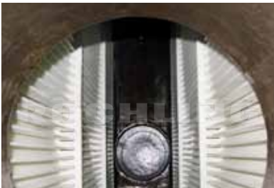
Rauchgaswäscher Flue gas scrubber Système de dépollution des fumées
