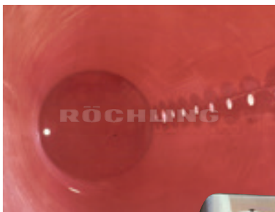
Trovidur® NL 蒸馏塔内覆层(内部视图)
